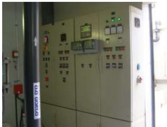
לוח פיקוד חשמל בבריכת שחייה של אחד מבסיסי חיל האוויר (צילום ד. לבקוביץ)
